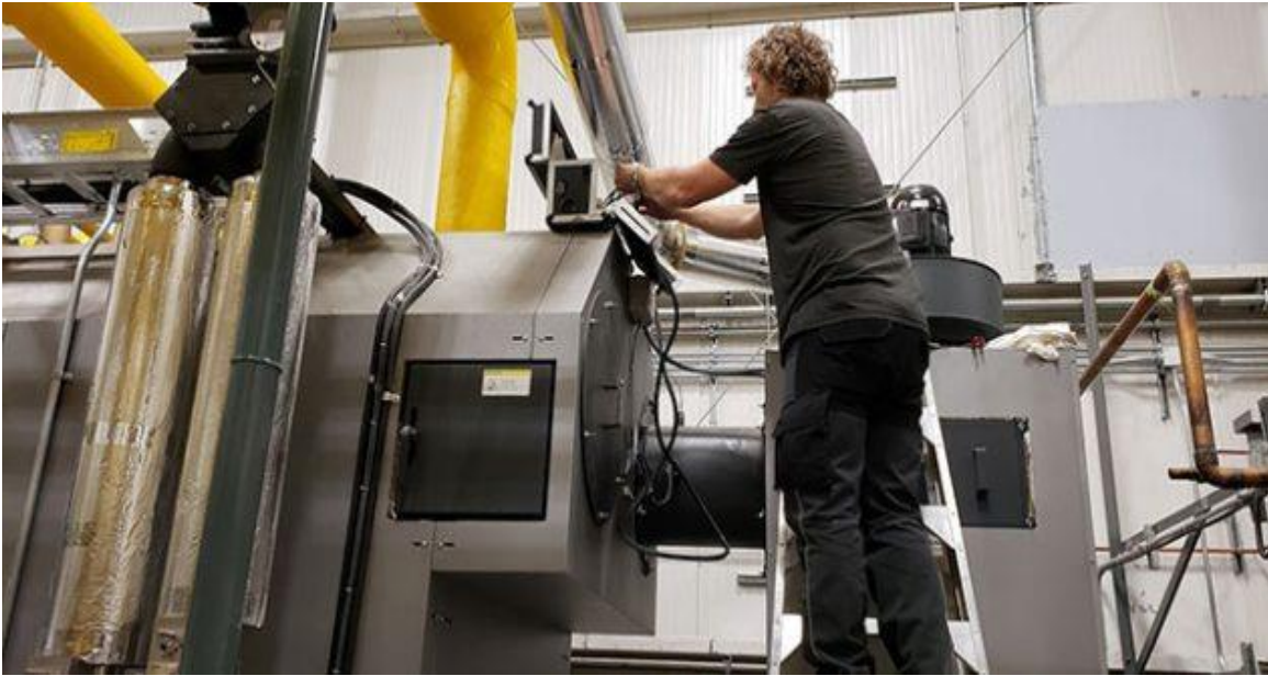
Nathaneal Dyck, technicien chez Fink Machine, teste les fumées sur une chaudière. Photo gracieuseté de Fink Machine.
